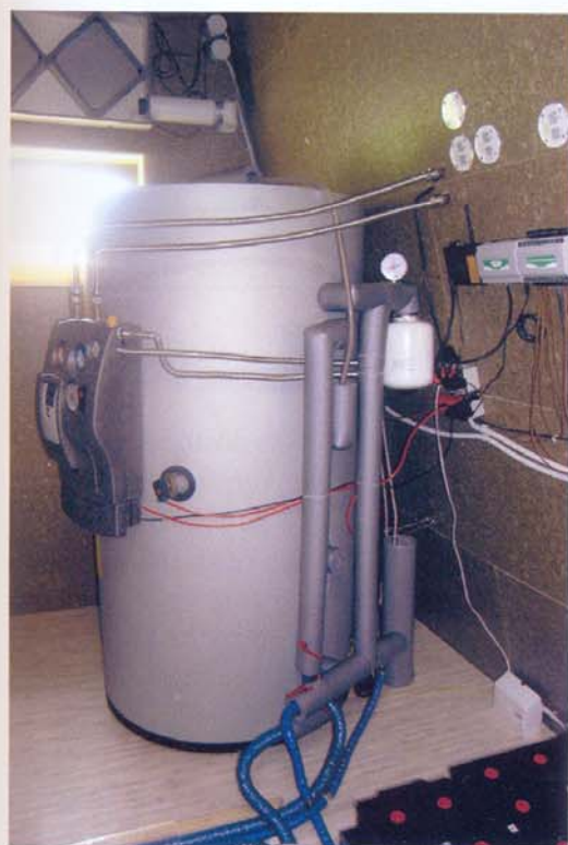
Slika 6 Hranilnik s prostornino 750 l, kjer se shranjuje odvečna toplota za ogrevanje celice in pripravo sanitarne tople vode
